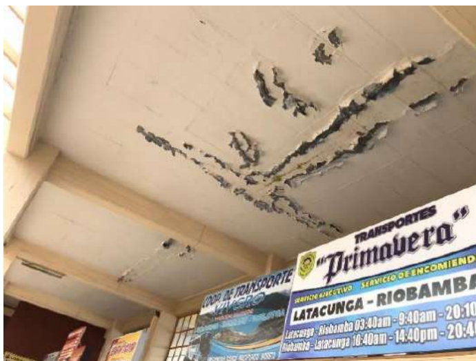
Fotografía 2: Deterioro de la cubierta del Terminal Terrestre
