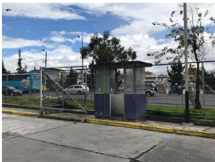
Imagen 13: Garitas sin funcionamiento en el Terminal Terrestre
