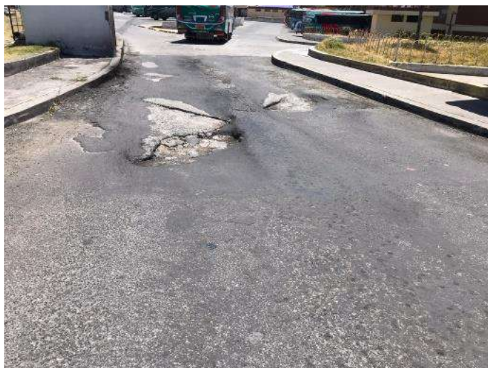
Fotografía 1: Deterioro en de las vías Terminal Terrestre
